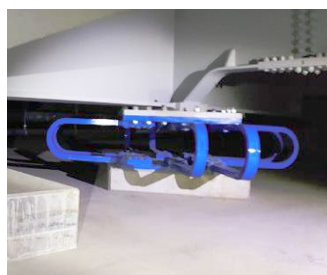
図5 U型ダンパー設置状況 (1階大梁下に設置)
